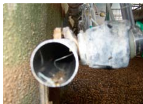
TUBERIA DE LAVADO OBSTRUIDA
