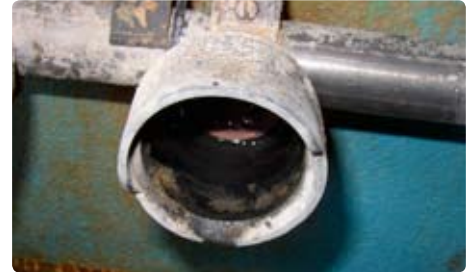
PLATAFORMA DE LAVADO SUCIA
